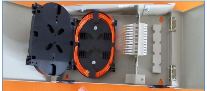
DIO PAREDE ATÉ 24F LC EQUIPADO COM 12F LC MM / VISTA SUPERIOR COM PORTAS DE ACESSO ABERTAS.
